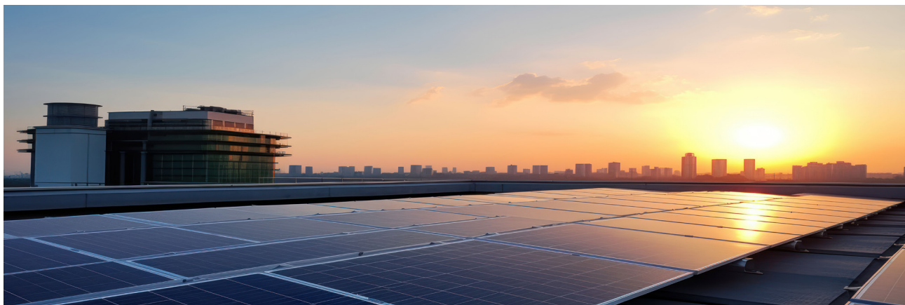
Figur 5: Kilde: Bygningsmontert anlegg (tak). AdobeStock, 2024.
