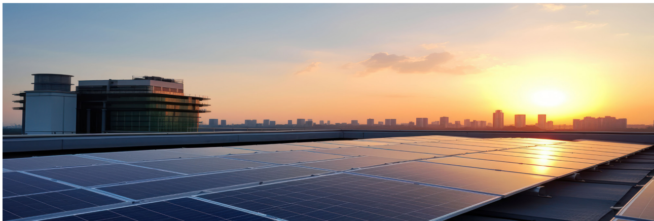
Figur 5: Kilde: Bygningsmontert anlegg (tak). AdobeStock, 2024.
