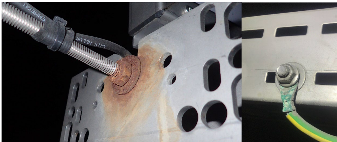
Bilde 1: Eksempel på korrosjon
