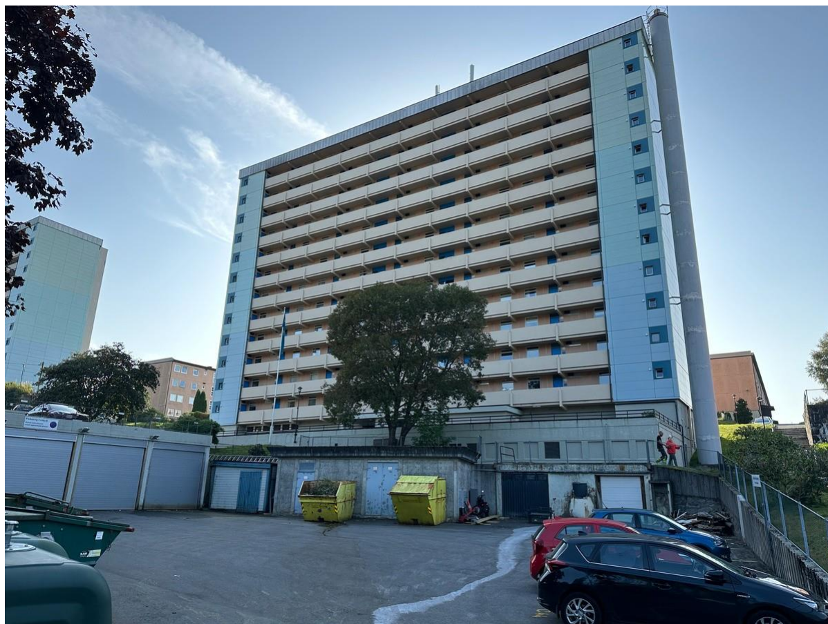
Figur C.4 — Nettstasjon plassert foran boligblokk
